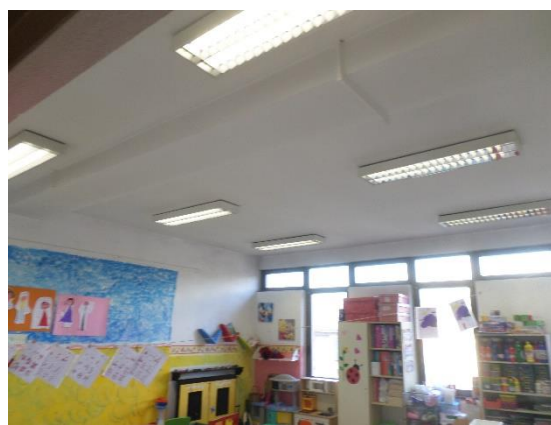
Figura 7.12 - Particolare dei corpi illuminanti attualmente installati
