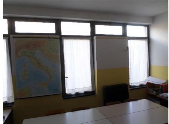
Figura 7.8 – Particolare radiatori attuali
