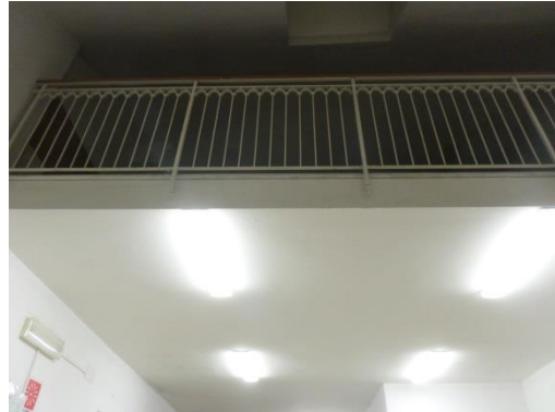
Figura 4.11 - Particolare dei corpi illuminanti ubicati nell'atrio
