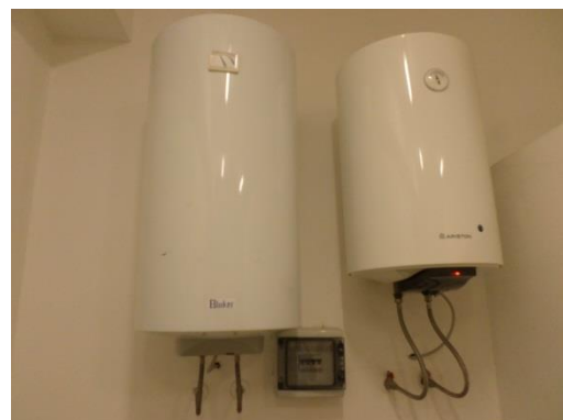
Figura 4.9 - Particolare di un boiler elettrico per la produzione di acqua calda sanitaria
