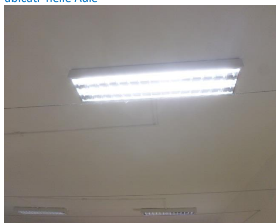
Figura 4.10 - Particolare dei corpi illuminanti ubicati nelle Aule
